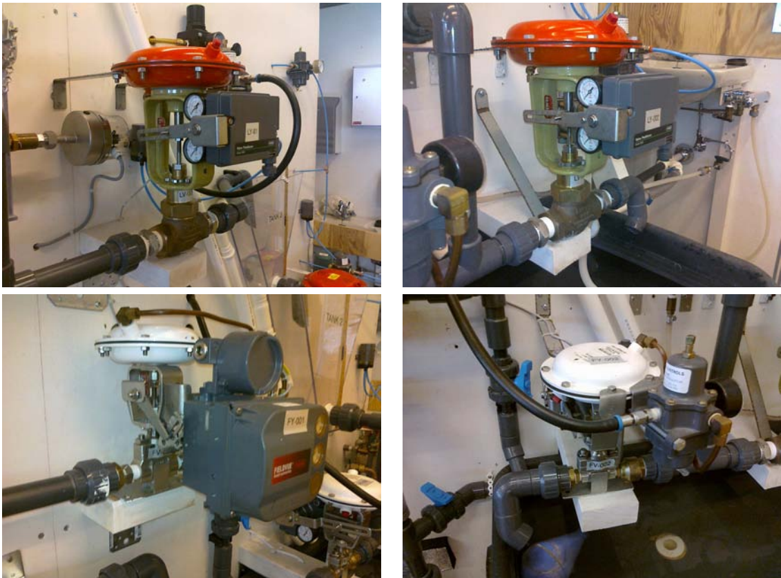
Figur 2.10: Ventilene på testanlegget. Oppe til venstre: LV001, oppe til høyre: LV002, nede til venstre: FV001 og nede til høyre: FV002
