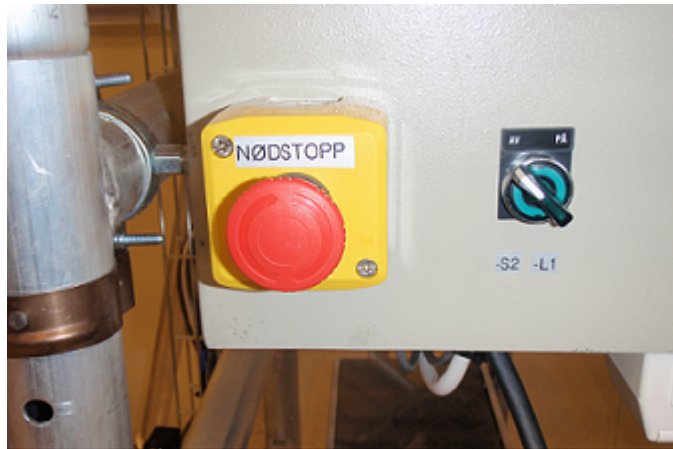
Figur 2.17: Viser brytere på kontrollskapets ytterside, den til venstre i bildet er nødstoppbryter, denne slåes inn dersom pumpa må stoppes på kort varsel, for nullstilling må bryter vries ut så den kommer i “på-posisjon”. Bryteren til høyre er til start/stopp av pumpa, uten denne i på-posisjon vil ikke pumpa kunne starte .
