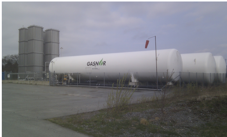
Figur 2.1: Gassforsyningsanlegget ved Alcoa Lista
