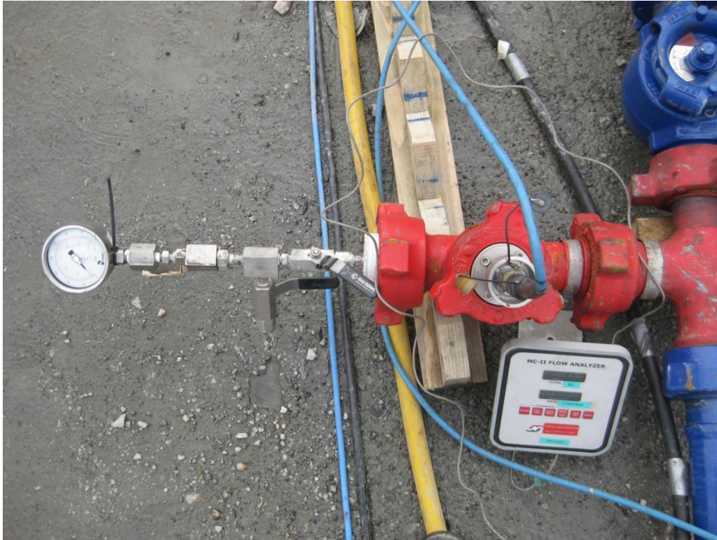
Appendix 9a: Pressure gauge
