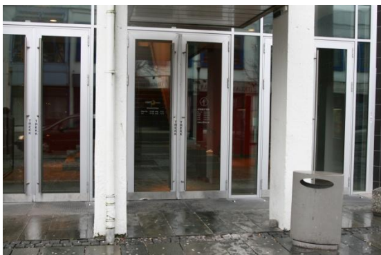
Hovedinngangen til Kino 1 og som også er en av hovedinngangene til Amfi Vågen tilfredsstillerr ikke kravene til universell utforming.
