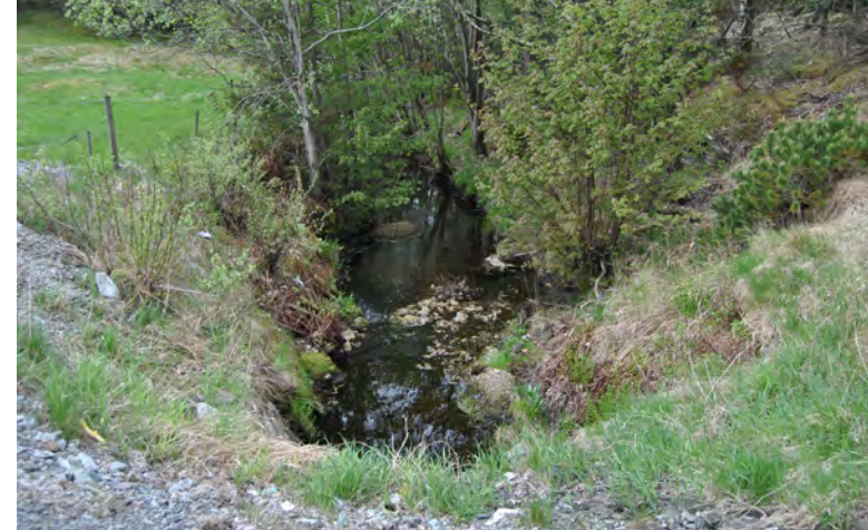
ill. 24.2 - Dubberselva er lagt i rør under Fv47, derfra renner den ut av røret og ned til Tornesvatnet
