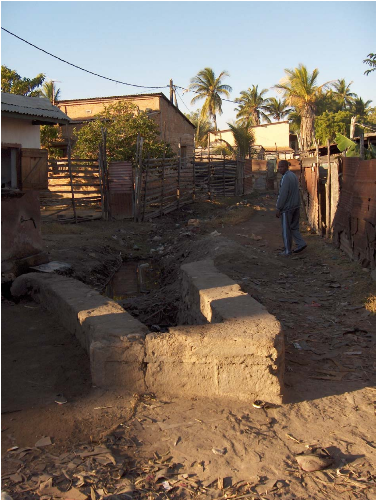
Bilde 3-3 Bildet viser tappekrane for rent vann og avløpskanal
