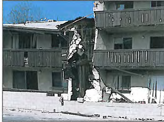
Figur 21, Ødeleggelser fra jordskjelvet i Northridge i 1994. Kollaps av første etasje i bygget til venstre [29].
