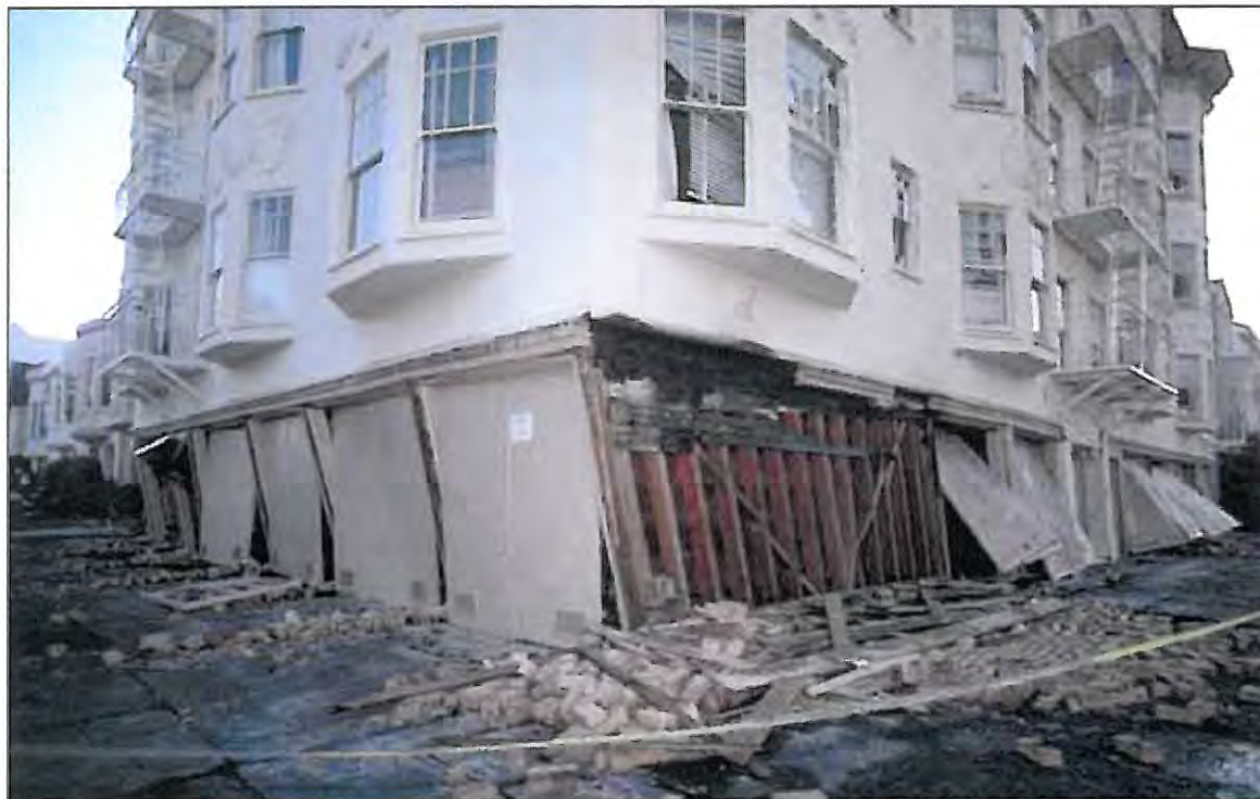
Figur 22, Kollapset førsteetasje i et bygg i Marina distriktet I San Francisco etter "Loma Prieta" jordskjelvet 1989. Jordskjelvet målte 7,1 magnitudo [26].
