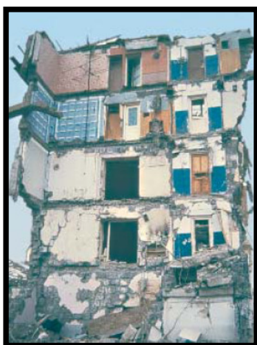
Figur 20: Kollapset bygning i Armenia[24]
