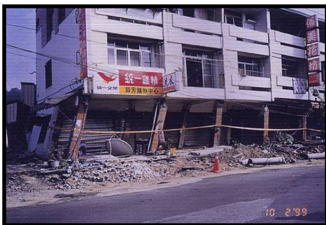
Figur 19: Typisk "soft storey"-skade[23]
