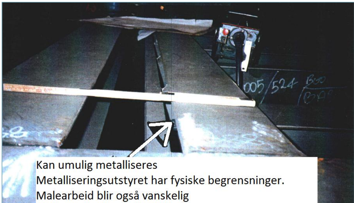
Figur 7.22: H-bjelker plassert for nærme hverandre
