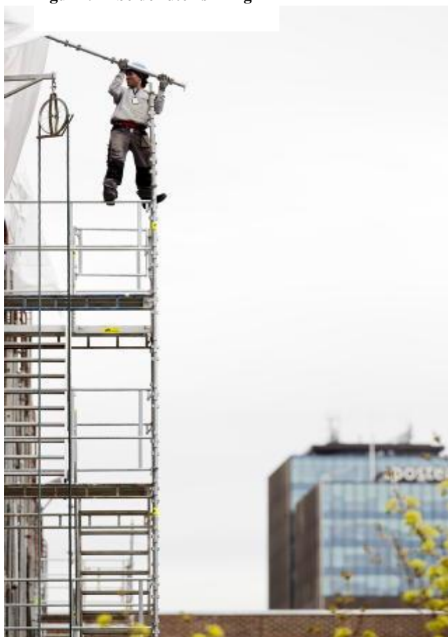
Figur 1: Arbeider uten sikring
