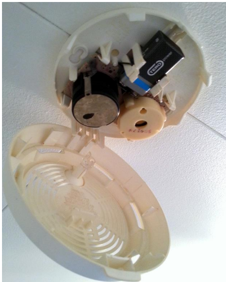
Figur 12. Røykvarsler som er fastmontert i taket (Beate Jenssen, 2013).
