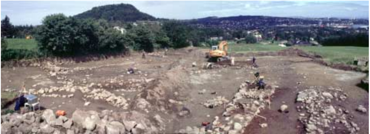
Fig. 66. Oversikt over hele felt E under utgraving. Jordvollen tvers over området dekker IVAR vannledningen. Foto: J. Aakvik. Fig. 66. View of the excavation of area E. The earthworks dividing the area cover the IVAR pipeline. Photo: J. Aakvik.
