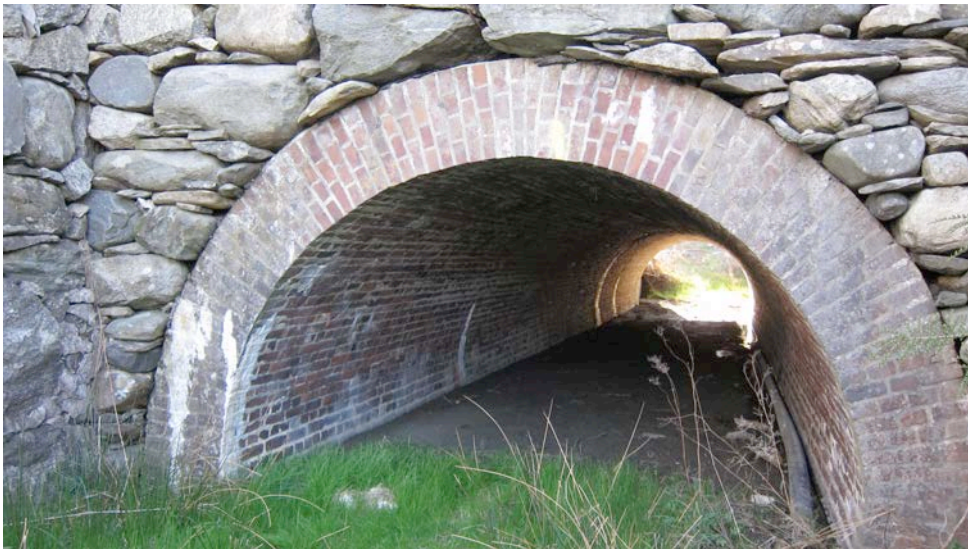
Foto 19: Tunnelen under veien til skinnegangen under hovedvegen. Bygget i 1936. Foto. Evy Vikingstad
