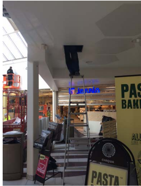
Figur 10: Arbeider balanserer på toppen av gardintrapp og bryter sikkerhetsreglene.
