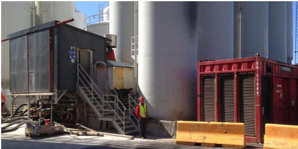
Figur 24 Oversiktsbilde av OBM miksehus, bulktanker og dieselpumpe til share-enheten
