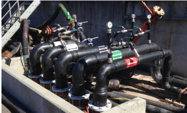
Figur 20 Rørgater tankside fra kai 3
