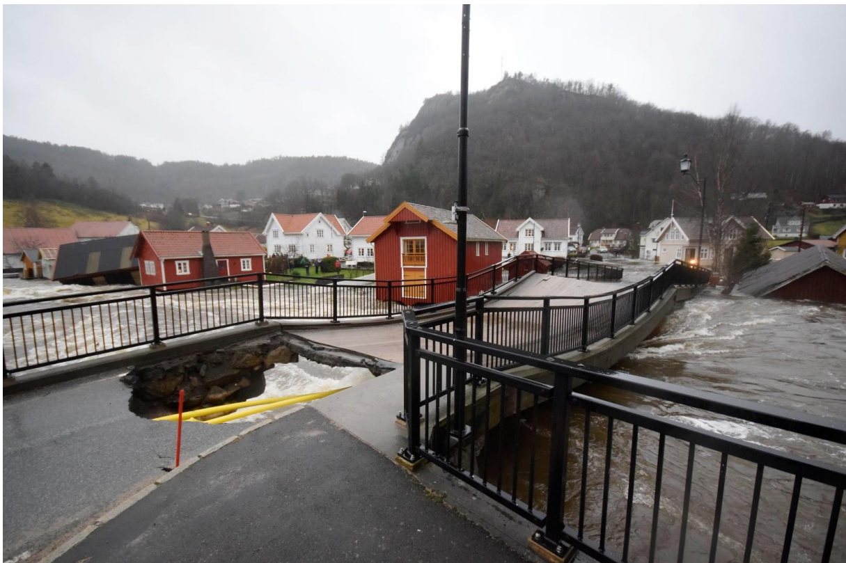
Figur 25 Broen i Feda ble ødelagt under ekstremværet "Synne" ("Storflom i feda i kvinesdal [bilde]," 2015).
