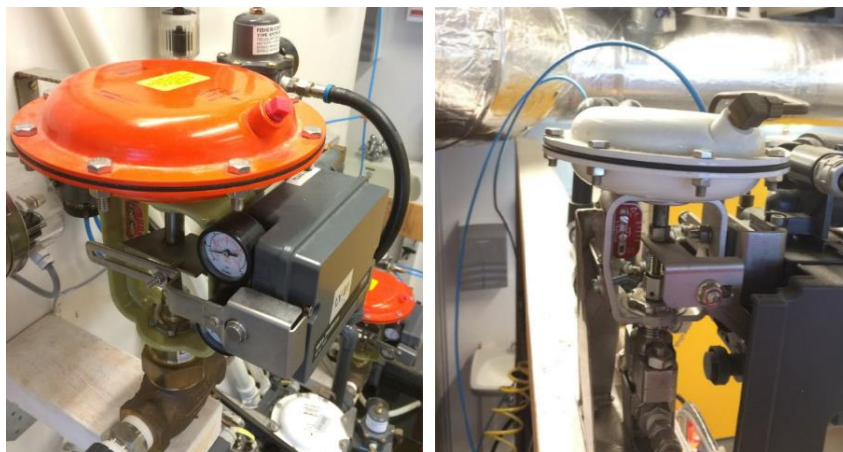
Figur 2.5: Venstre, LV001 og høyre, LV003
