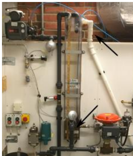
Figur 2.1: Bilde av tanken med tilhørende utstyr
