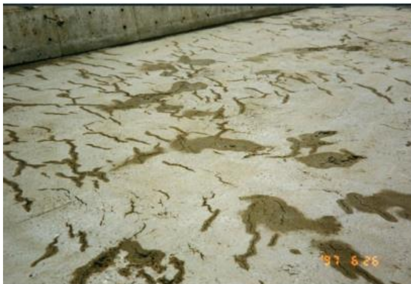
Figur 4-6 Alvorleg opprissing forårsaka av plastisk svinn [Foto: Reidar Kompen, SVV]
