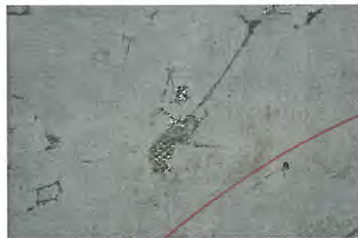
Figur 21: Skadeområder etter fjerning av retusjer og overmaling.
