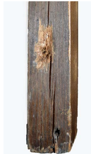
Figur 30: Oppfliset skade i nedre venstre hjørne
