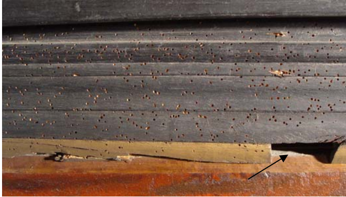
Figur 24) Flygehull fra borebiller på fremsiden av øvre prydrammeliste. Pilen markerer i tillegg bortskåret treverk.
