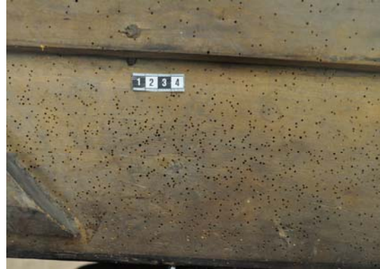
Figur 25) Flygehull fra borebiller på baksiden av nedre prydrammeliste.
