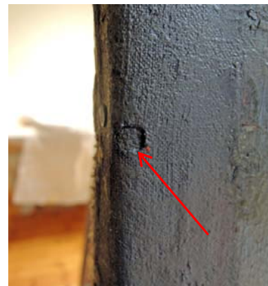
Figur 10) Detalj av originalt oppspenningshull (overmalt) ved venstre ombrettkant
