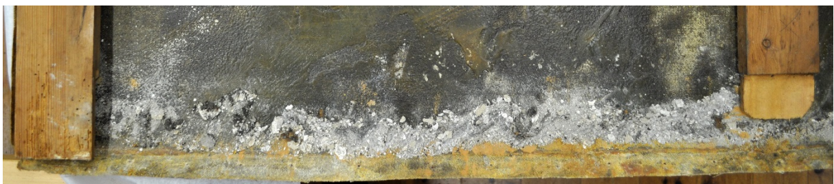
Figur 38 Nedre blindrammeliste er fjernet. Det var fortsatt mye støv og murpuss
