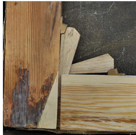
Figur 37 Detaljfoto av blindrammens nedre venstre hjørnet etter behandling
