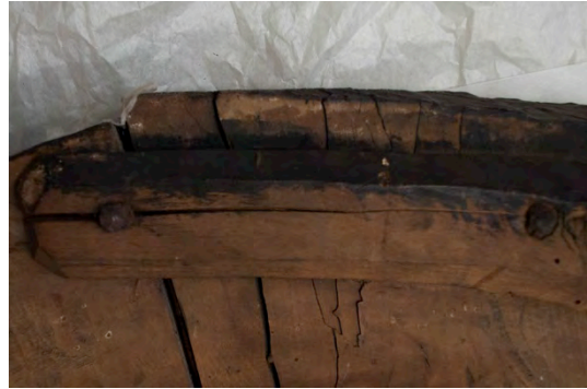
Fig. 72 Detaljebilde av en sprekk i en labank på epitafiets venstre, øverste side
