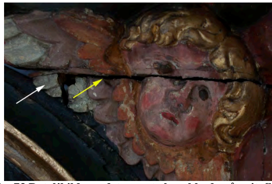
Fig. 73 Detaljebilde av det øverste kerubhode på epitafiets høyre side. Hvit pil: løs del; gul pil: sprekk i sammenføring
