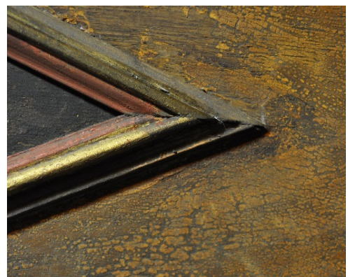
Fig. 16. Detalj av nedre smalfelt på felt 1. Kraftige, åpne «krokodilleskinns»krakeleringer sees.
