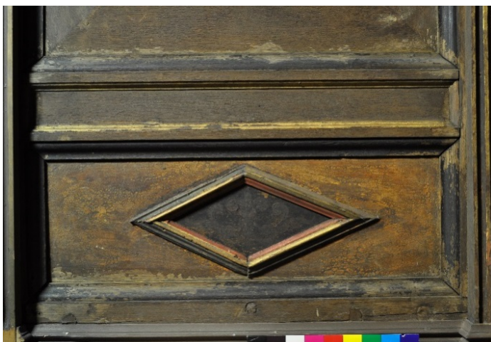
Fig. 15. Nedre del av felt 1. Oppbrutt og avskallet maling sees spesielt på de horisontale listene.
