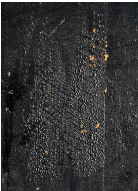
Fig. 10. Varmeskadd parti på nedre fyllingsfelt på dørbladets korside.
