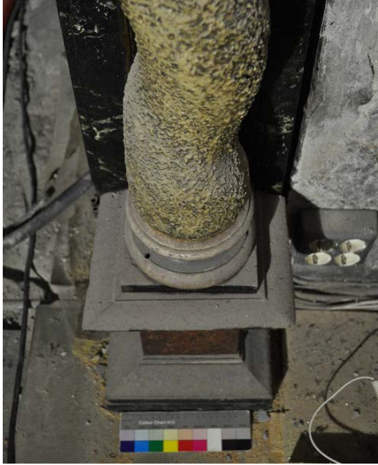
Fig.16. Nedre del av venstre søyleskaft og sokkel som viser støvmengde på overflaten før behandling.
