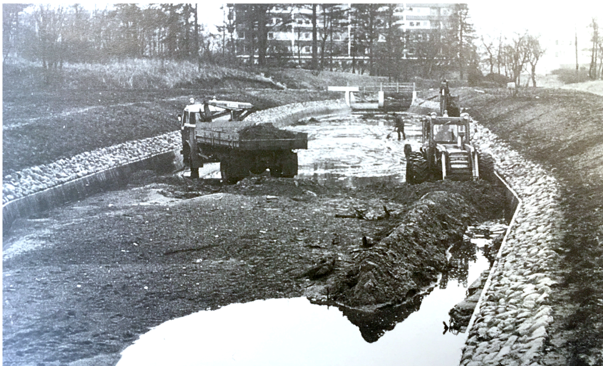
Figur 48: Mye arbeid krevdes for at Storåna-vassdraget skulle strøme i innretningene menneskene hadde anlagt i vassdraget. Her tømmes sedimenter fra sandfangbassenget.
