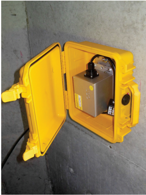
Figur 3.15 Akselerometer i tårn, nordlig tårnben. Foto: Jonas Snæbjørnsson
