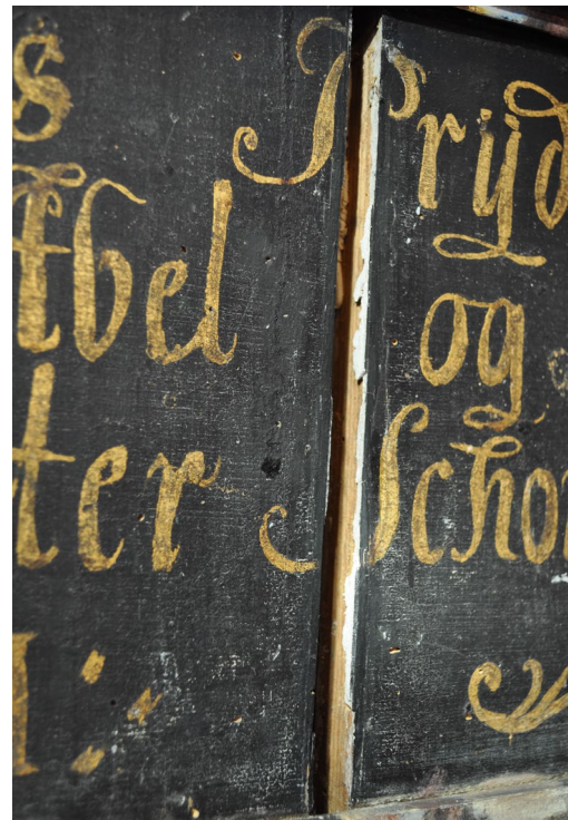
Fig. 14. Detalj høyre del av skriftfelt. Viser sprekk med sekundær kitting, makkhull og stearinsøl på overflaten.
