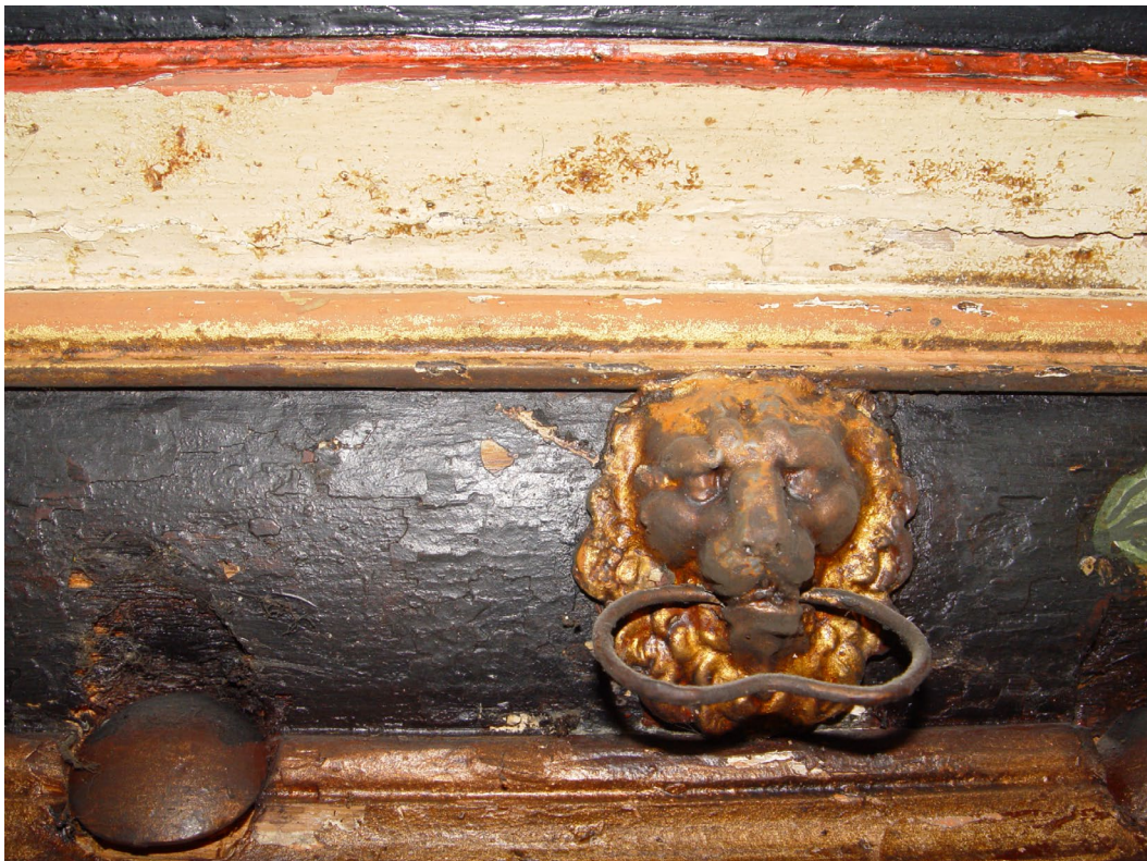
Foto 7. Detalj av himlingens nedre omramming. Viser slitasjer, tidligere retusjeringer, opp- og avskallinger og rester av ferniss.
