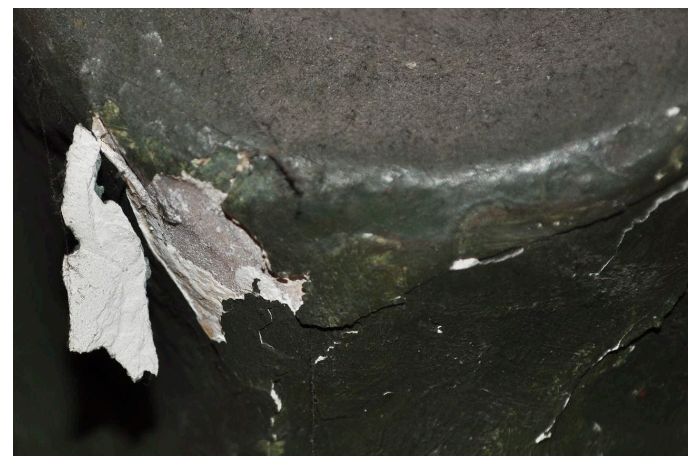
Foto 12: Detalj av løs maling på Johannes' konsoll
