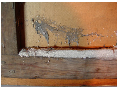
Foto 3: Detalj av murpussansamling på nedre blindrammekant (venstre hjørnet)
