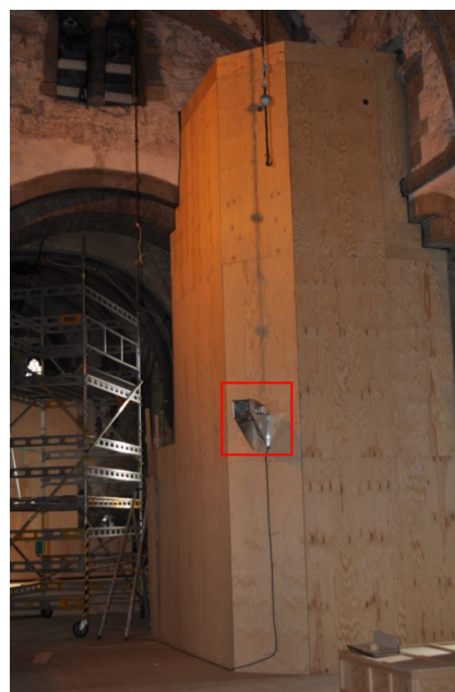
Prekestolen innkasset. Utvendig vifte merket med rødt.
