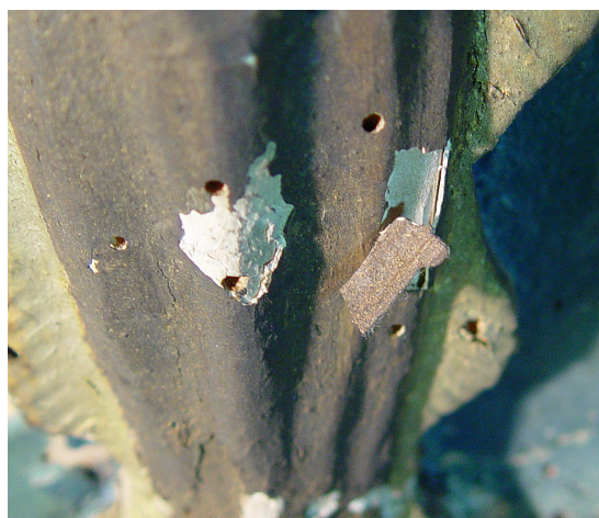
Foto 4: Løs og avskallet maling (midtre utskårne element på øvre rammekant)
