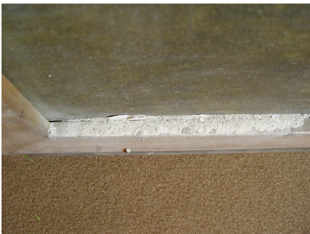
Foto 3: Murpuss langs nedre blindrammekant
