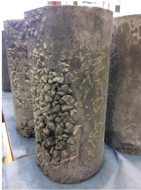
Figur 15 - Dårlig utstøpt sylinder
