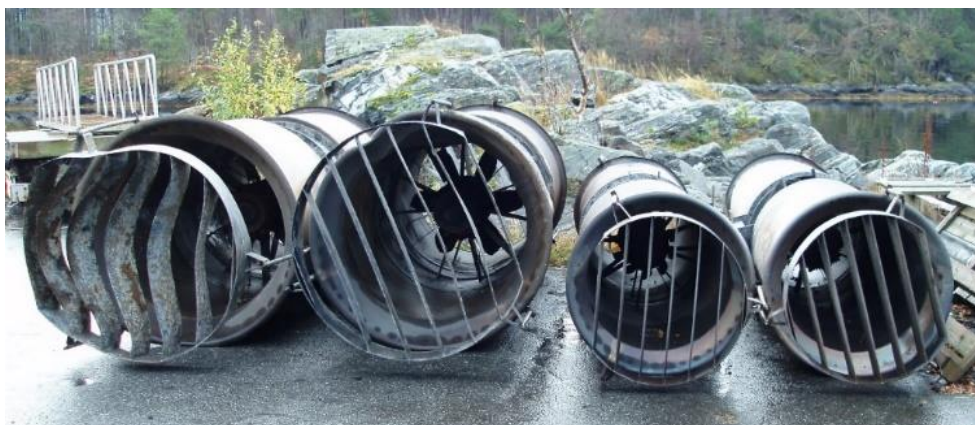
Bilde 11 Skade på ventilatorene fra brannen i Skatetraumtunnelen
