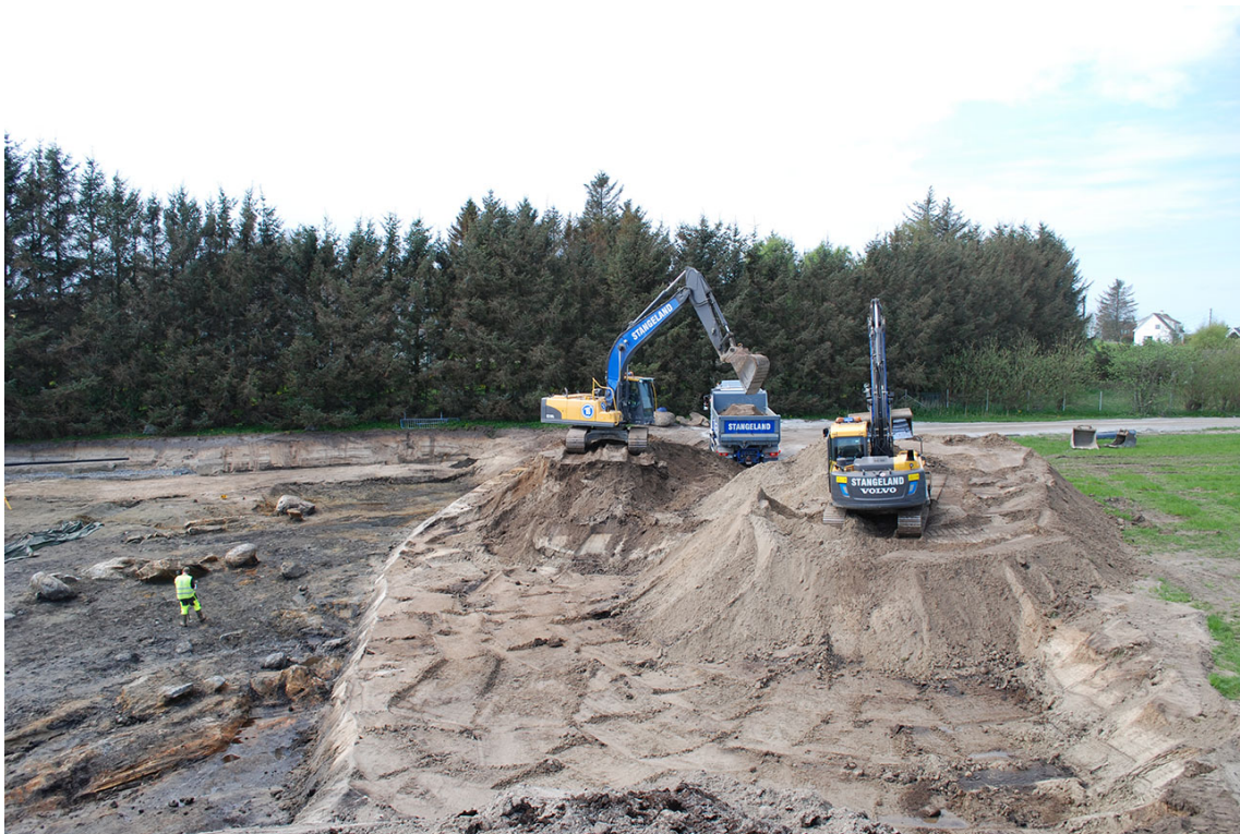
Fig. 7. Til tider var det to maskiner og to lastebiler i sving for å fjerne de tykke torv- og sandlagene. Her fra avdekking mellom lokalitetene 8 og 9. Sett mot V.
