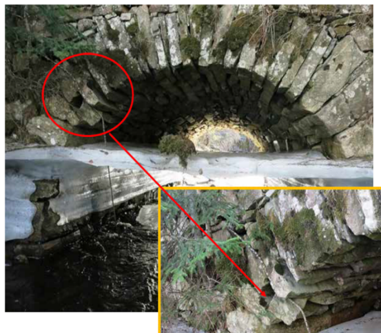
Figur 42: Utglidning i ytterkant av en steinbru [15]
