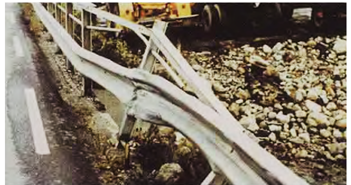
Figur 17: 3V= Skade som har innvirkning på trafiksikkerheten. Den kan utvikle seg til at reparasjonen blir mer kostbar, og kompleks om den ikke renoveres innen 1-3 år [13]
