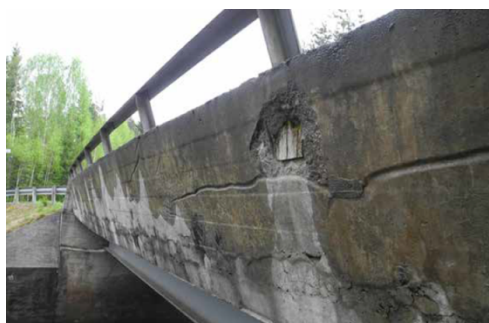
Figur 31: Avskalling på et betongrekkverk [15]
