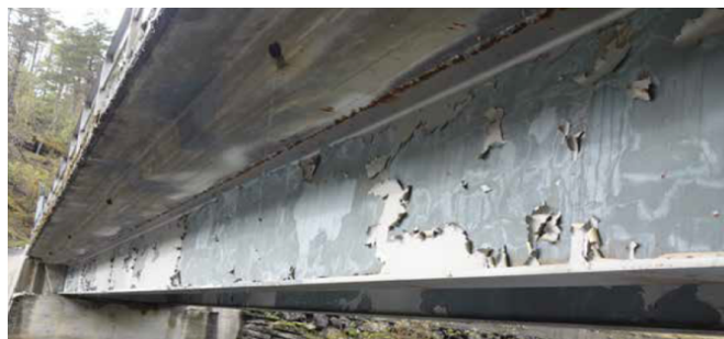
Figur 41: Skade på overflatebehandling, avflaking over 50% [15]
