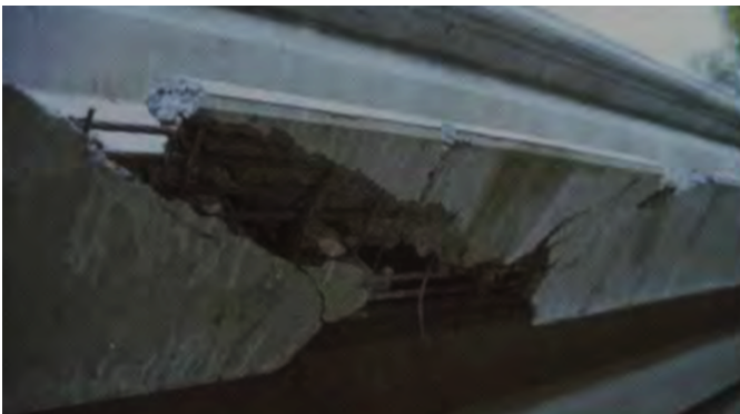
Figur 16: 4B= Alvorlig skade, truer bruens bæreevne. Bør repareres innen ½ år [13]
