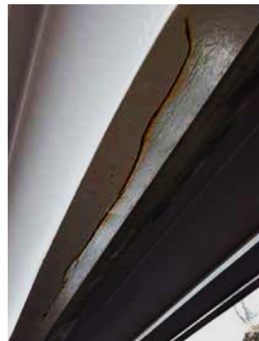
Figur 38: Sprekk i en stålbjelke [15]
