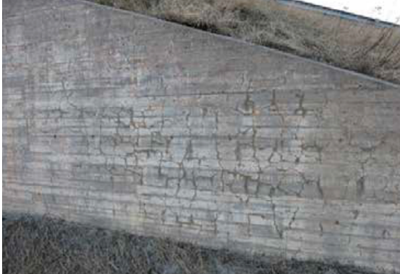
Figur 24: Rissmønster i en betongvegg [15]
