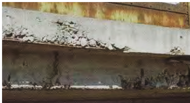
Figur 33: Støpesår i dekkekant [13]
