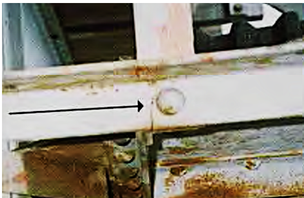
Figur 39: Sprekk i vinkel med naglen [13]
