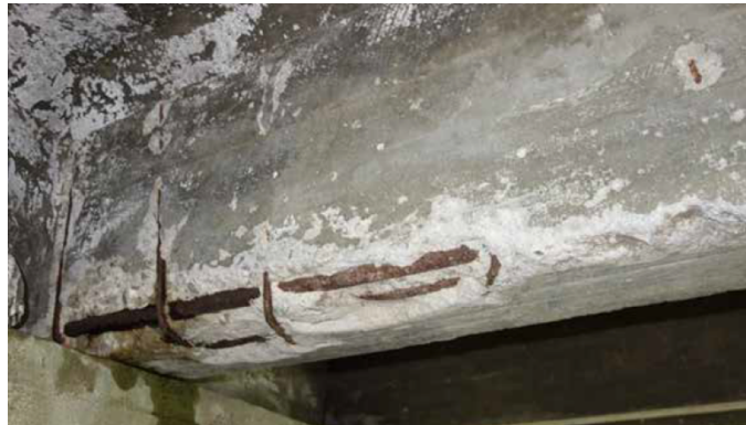
Figur 34: Korrosjon i armeringen [15]
