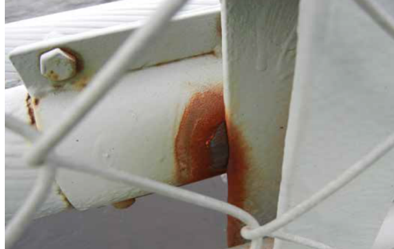
Figur 40: Slitasje og gnissing i stålelement [15]
