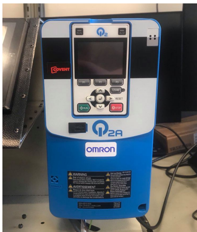
Figur 2.5: Bilde av frekvensomformeren brukt i oppgaven.
