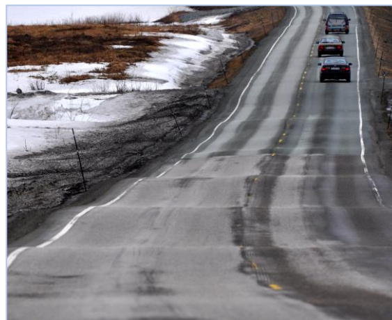
24 Fylkesvei 17 i Nordland med kraftig telehivsskade.
