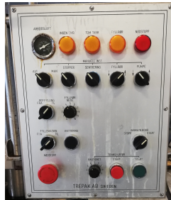
Figur 2.2: Brukerpanelet til det eksisterende systemet.
