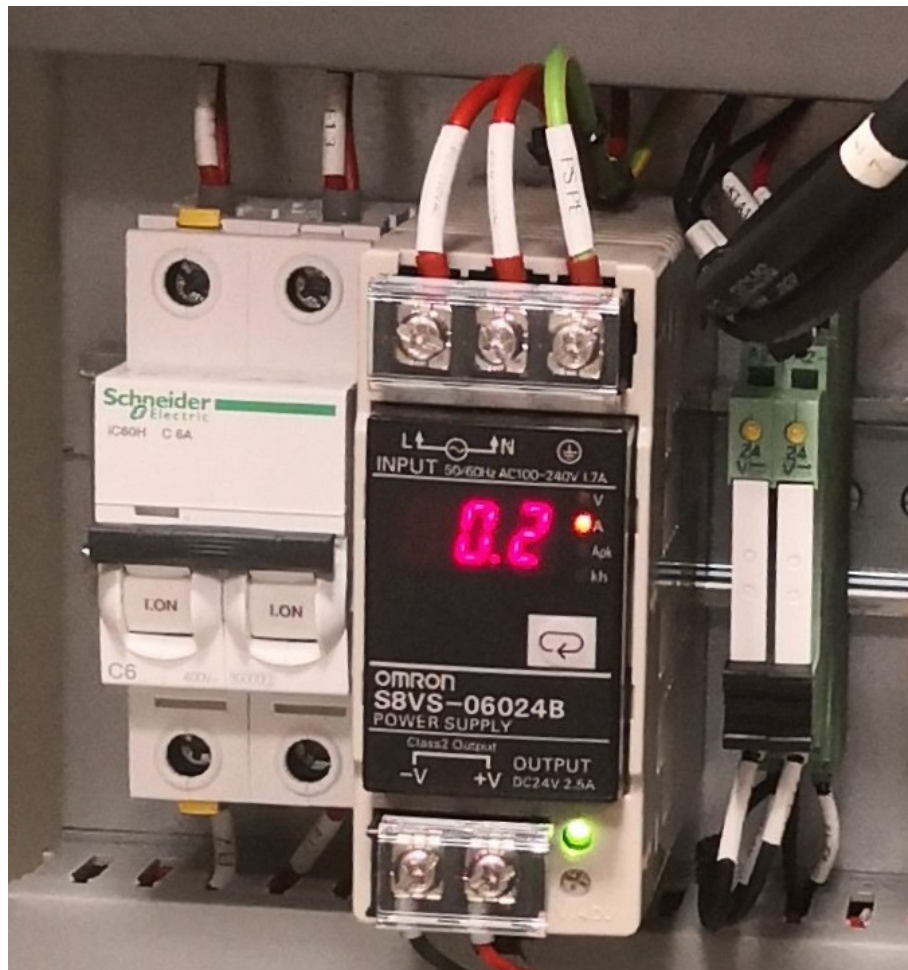
Figur 2.14: Fra venstre: Hovedsikring for styreskapet, strømforsyning og kontaktorer.
