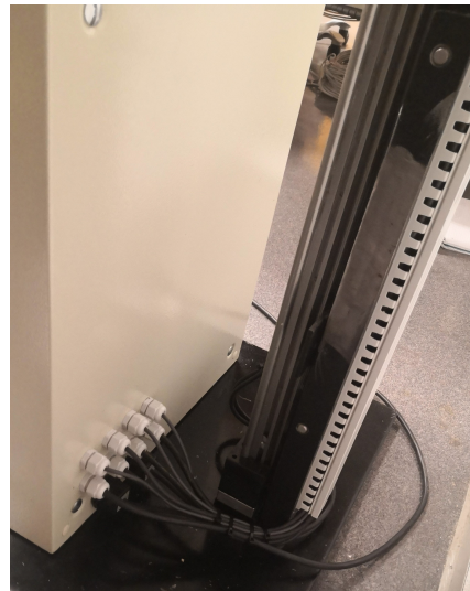
(b) Kabelgjennomføring til styreskap.
