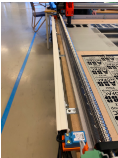
(a) Fast montert kanal for kabel føringer
