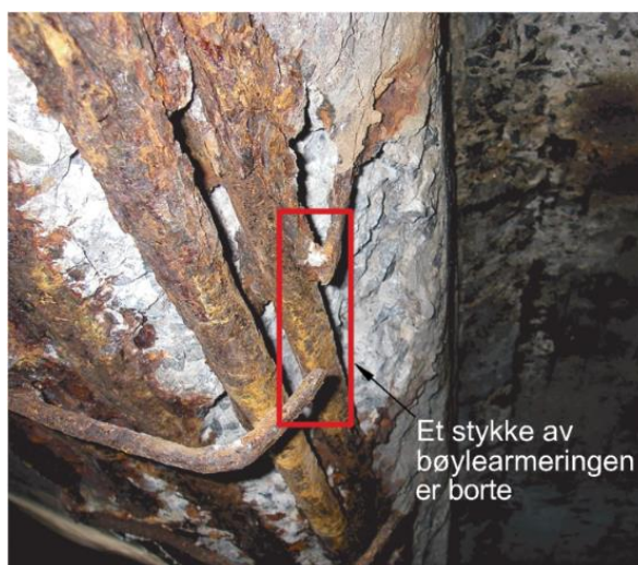
Figur 4 Eksempel på at kloridinitiert korrosjon [10]
