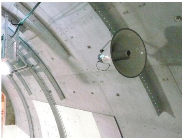
Figur 16 Illustrasjon av høyttaleranlegg i tunnel (PIARC, 2016, s. 30)
