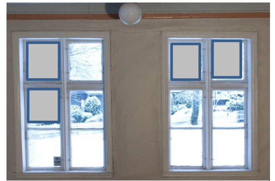
Fig. 100. Vinduene på vestvegg. Rammer med eldre, «ruglete» glass er markert med grått.
