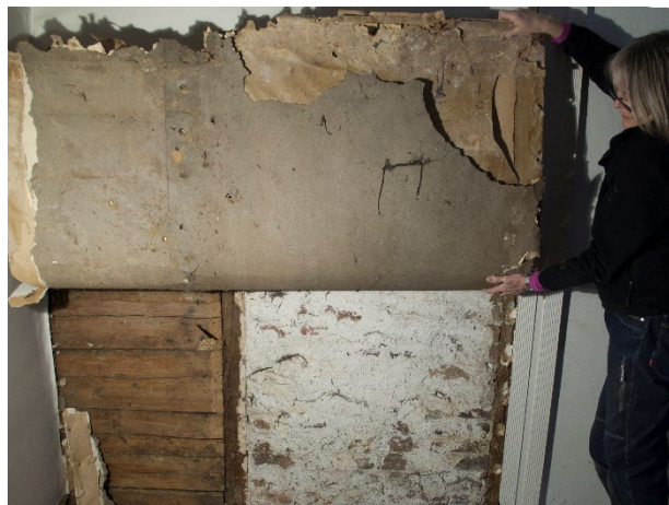
Fig. 81. Nordre del av østvegg. Løsnet veggtrekk.
