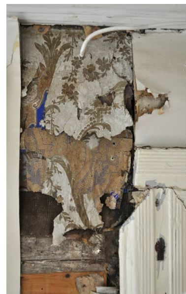
Fig. 29. Tapetlag og spor etter hvitning på treverk.
