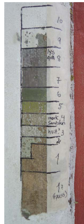
Fig. 23. 10 lag maling er dokumentert på vindusgeriktene.
