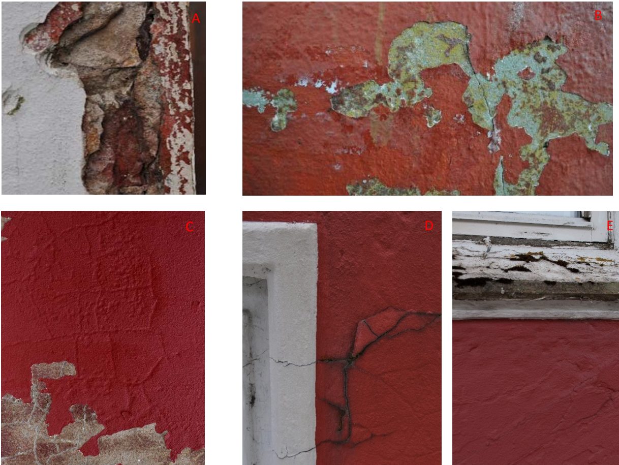
Fig. 15. A: Flere pusslag/reparasjoner B: Avskallet maling C: spesielle riss D: Sprekker i puss på vegg og gerikter. I enkelte sprekker knyttet til løsnete pusstykker vokser det mose. E: Oppsprukne vannbord og spor i puss av ombygging og reparasjoner.
