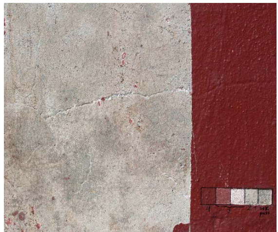
Fig. 17. 1. etg. østvegg. Parti med veggens tre første lagkalkmaling. Lagene er nedbrutt og farge endret.
