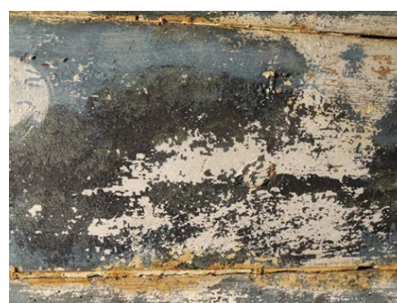
Fig. 33. Detalj av trekrone nordøstre hjørne. Viser avskallinger og tallrike små oppskallinger knyttet til fuktsskadd område.
