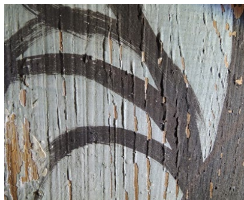
Fig. 35. klimarelaterte opp- og avskallinger ved søndre tre på østveggen stående panel.
