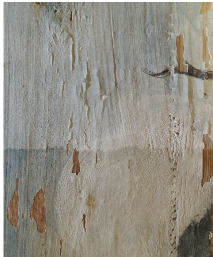
Fig. 42. detalj fra østvegg som viser tørr, ubehandlet flate med opp- og avskallinger i øvre del og konsolidert felt før opptørring i nedre del.
