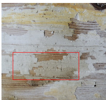
Fig. 31. Detalj av fuktsskadd parti med rutete krakeleringsnettverk i bunnfargen på østveggenstømmervegg(markert).
