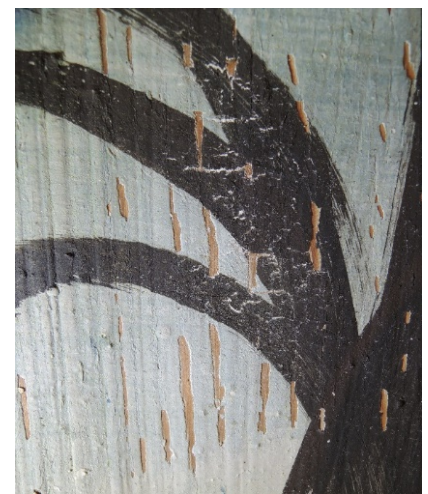
Fig. 44. Detalj av de klimarelaterte opp- og avskallingene ved søndre tre på østveggen stående panel (fig. 35) etter konsolidering.
