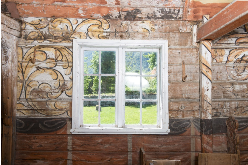
Fig. 38. Østre del av tømmervegg på sørsiden. Rankedekoren er helt borte på vestre side av vinduet som følge av vanninntrengning som har rent ned veggen.
