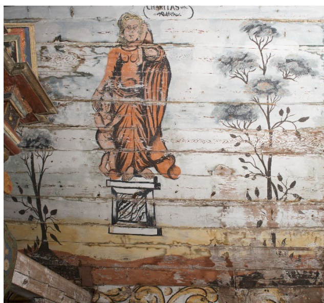
Fig. 30. Østre del av sørveggen viser et generelt skadebilde med fuktsskjolder, misfargete partier og opp- og avskallinger.
