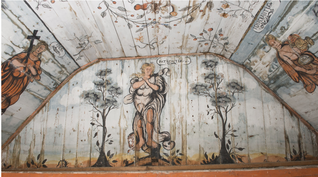
Fig. 6. Korets panelte elementer sett mot vest. Vestveggenes gavlf med Patientia , sørveggen med Fides , nordveggen med Temperantia og vestre del av himlingen før behandling. Baksiden av tverrgående bjelke med påskrift sees i forgrunnen.
