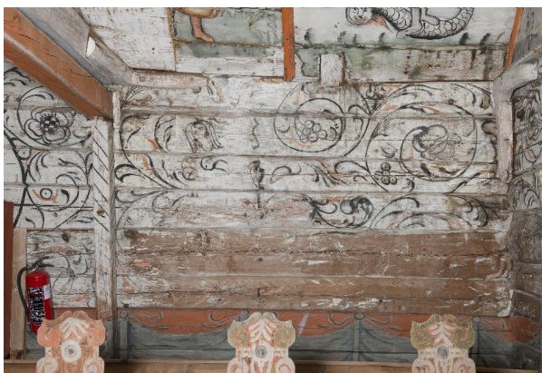
Fig. 55. Nordvegg. Østre del. Tømmervegg med slitasje
