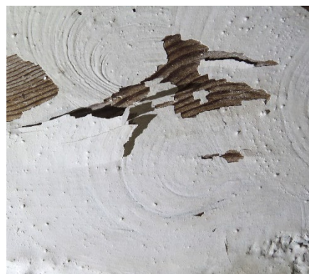
Fig. 13. Himlingens østre felt. Detalj av bunnfarge med penselstrøk som markerer plassering av skyer. Små klumper sees i malingen til høyre.
