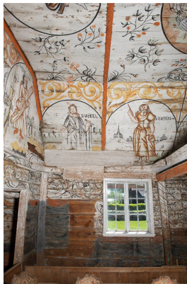
Fig. 5. Østre del av sørvegg med dekor på tømmervegg, skråhimling og del av himling. Negativt spor etter prekestolens tidligere plassering.
