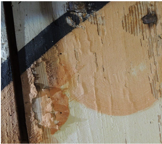
Fig. 49. Himling, Midtfelt. Detalj av medaljong som viser opp- og avskallinger som følger treets vokseretning. For konsolidering.
