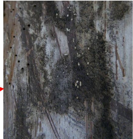
Fig. 54. Vestvegg. Nordre del. Detalj av fastsittende smuss, støv og finkornet sand på overflaten.
