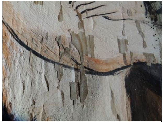
Fig. 50. Himling, Østre felt. Detalj av engel som også viser opp- og avskallinger som er klimarelaterte. For konsolidering.
