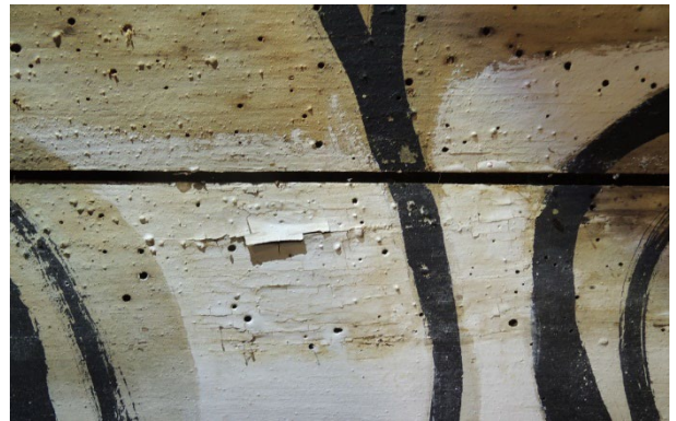
Fig. 52. Himling, Midtfelt. Område retusjert med Ticomatt. Oppbrutt maling og oppskallinger sees.
