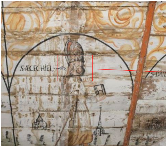
Fig. 43. Sørvegg. Skråhimling. Nisjemn med S. Æcechiel for rensing. Vannrenn har dratt med seg limfargen og gitt misfarging og råteskader.
