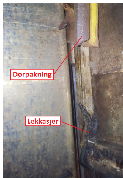
Figur C.4: Dørpakning montert som viser tegn til lekkasje.
