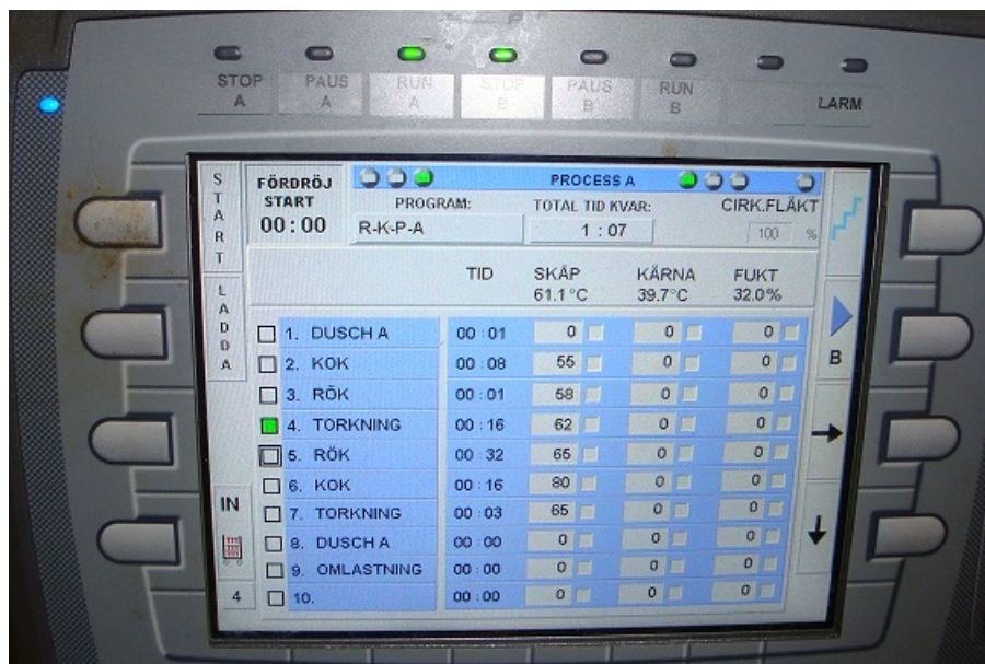
Figur 2.13: Operatørskjermen viser varmebehandlingsprosessen trinnvis (del-A).
