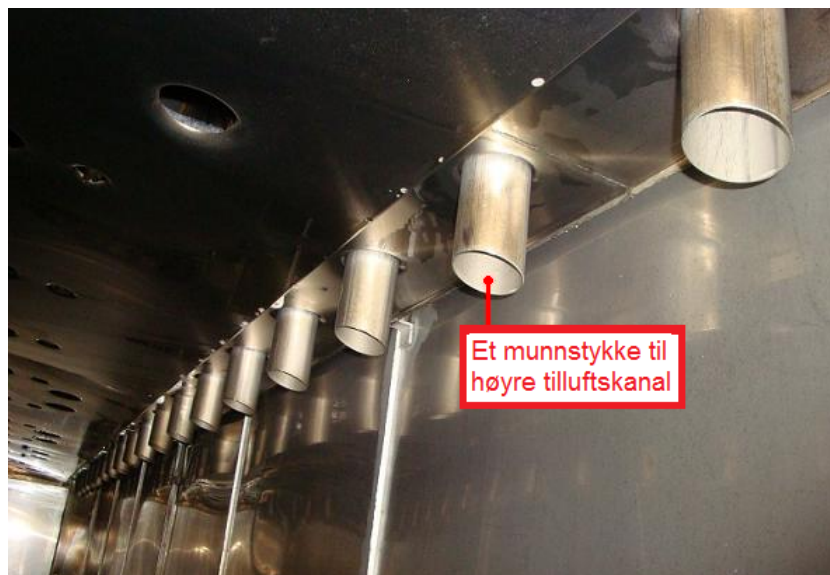
Figur A.2: Munnstykker tilhørende høyre tilluftskanal.
