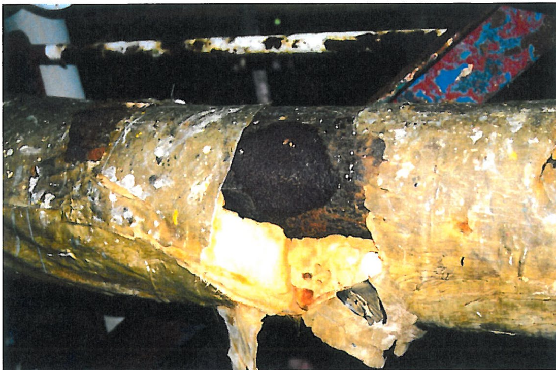
Bilde 6 - Korrosjon under isolasjon
