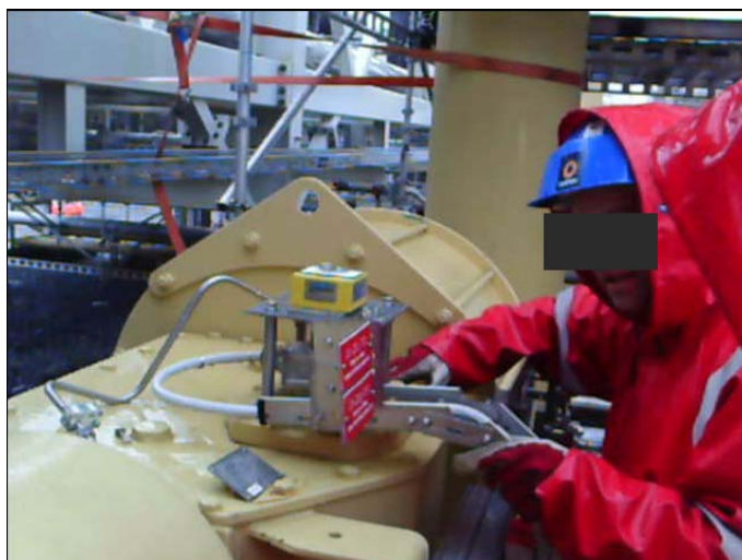
Figur 63 Feilsøking på ventil 20-HV-7191 av ingeniør (foto Svein Jarle Aasen)
