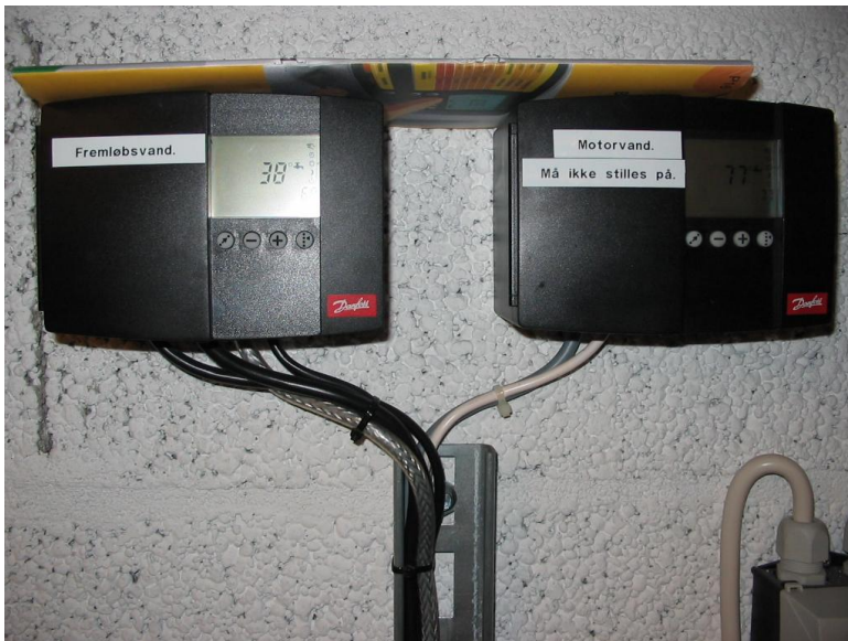
Figur 1 Motorvann og fremløpsvann regulatorer
