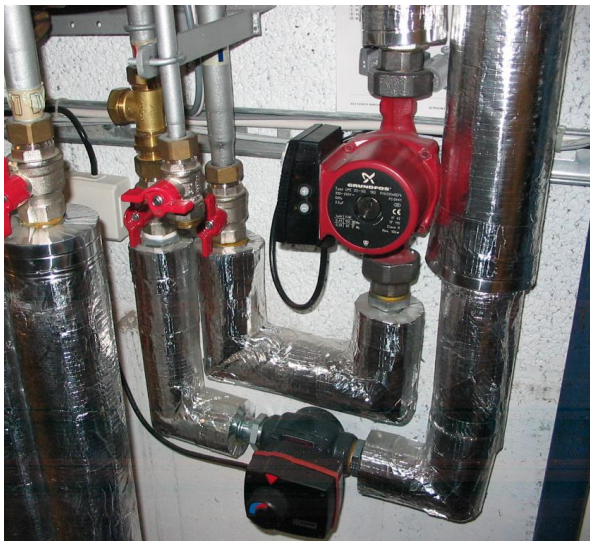
Figur 2 Pumpe og ventil for varmeleveranse fra kogenereringsanlegget
